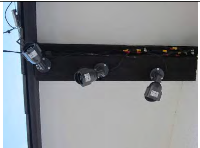
説明 カメラ設置状況
